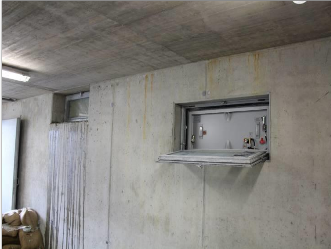
links Wassereintritt, Folien u. Sandsäcke
